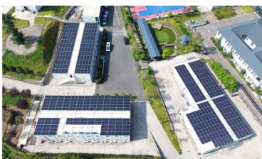
► 中交天津航道局宜宾项目部光储项目
